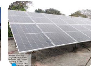
Block Mall - 15kW (Lucknow)
